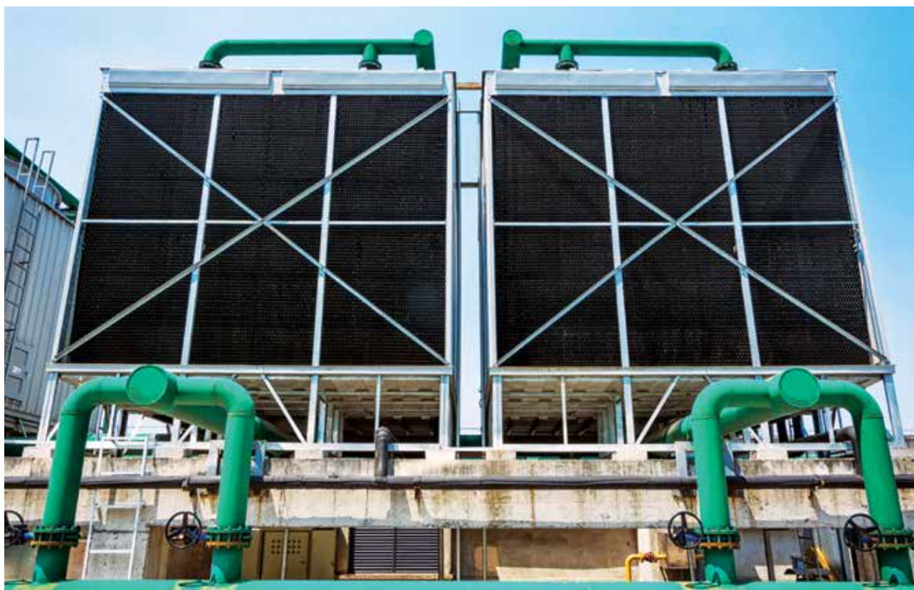
Sistema de resfriamento de unidade de data center, que utiliza água de reúso
